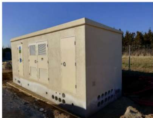
Photographie d'illustration d'un poste de livraison - source : étude d'impact environnemental
